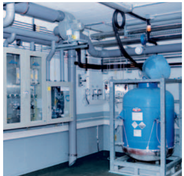
Vollautomatische HCl-Faßversorgungsanlage inkl. SECCURA® Cylinder Management
