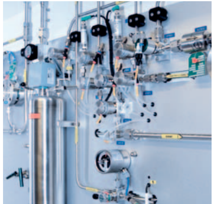
Armaturenschrank einer vollautomatischen Versorgungsanlage für Titan-tetrachlorid
