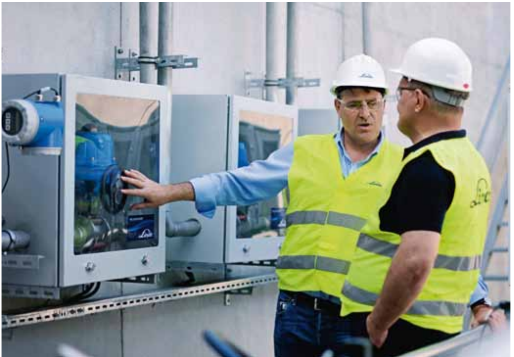
Darren Gurney, Sr. Process & Business Development Manager (links) und Omer Saray, Application Engineer (rechts), besprechen die Details des CO 2 -Dosiersystems.
